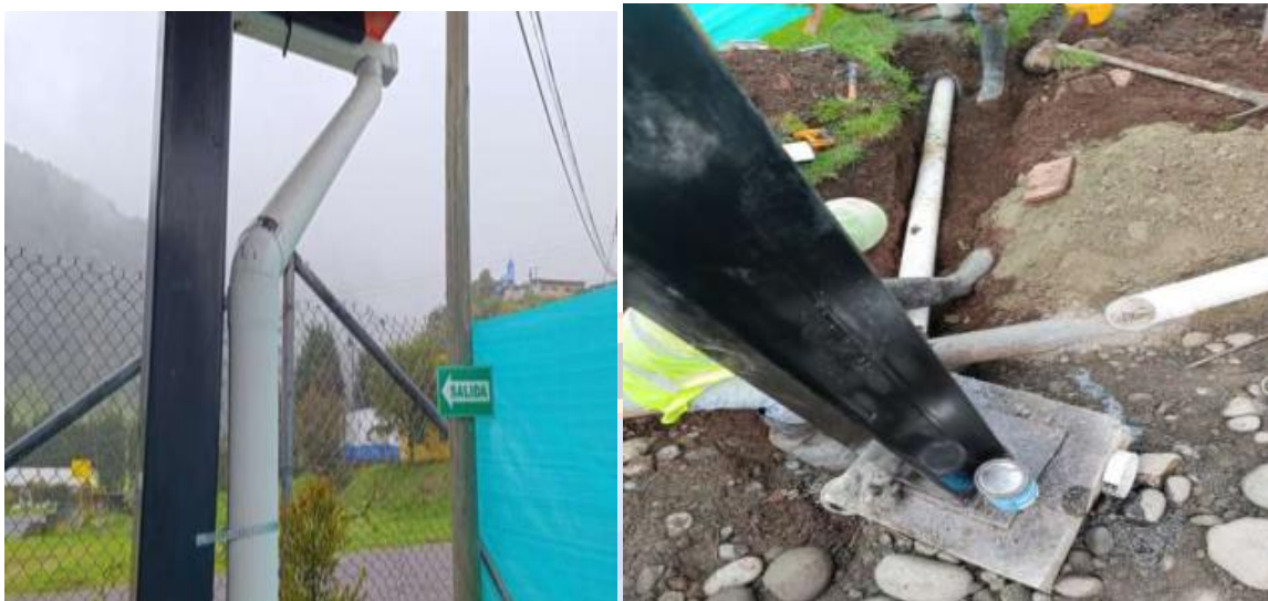
Fotografía No. 13. Bajantes de agua lluvia D=110mm
