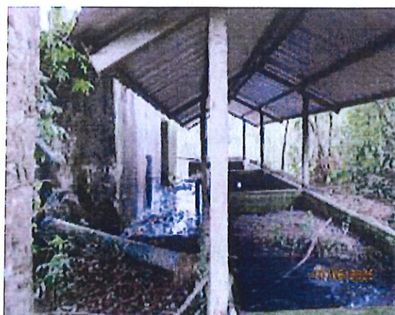
Foto 6. Tanque de sedimentación en la planta de tratamiento de aguas residuales.
