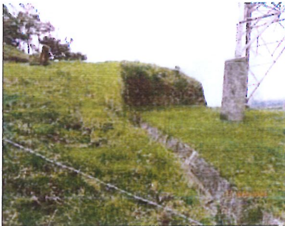
Foto 12. Canal para recolección de aguas de escorrentía superficial.
