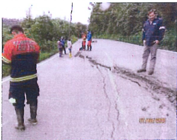
Foto 9. Tramo vial asentado por falla de borde sector Alejandría.
