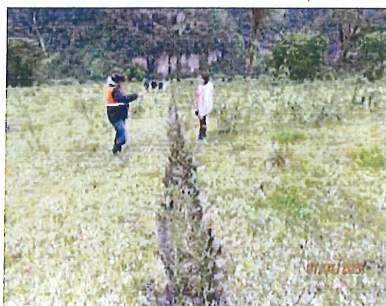
Foto 4. Canal para recolección de agua lluvia parte alta de zona urbana de Cuyuja.
